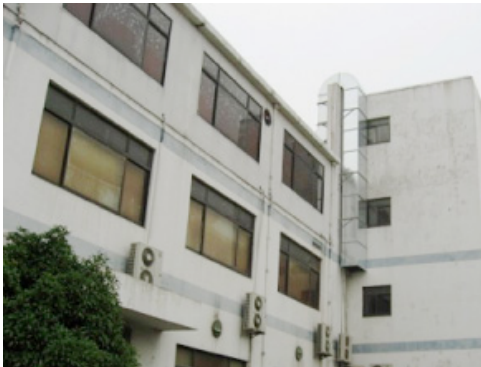
UV塗装工程排気ダクト
